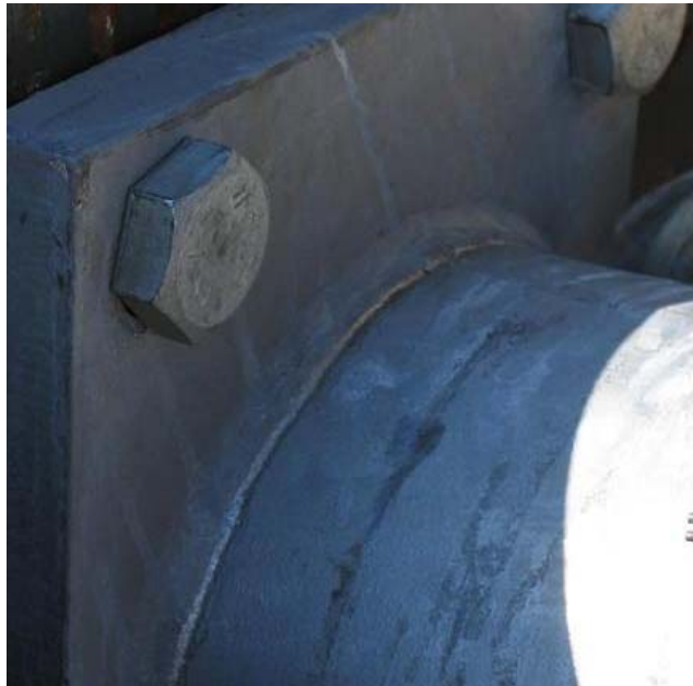
Figure 5.3.2.5 Completed Mast Arm Weld Toe UIT
